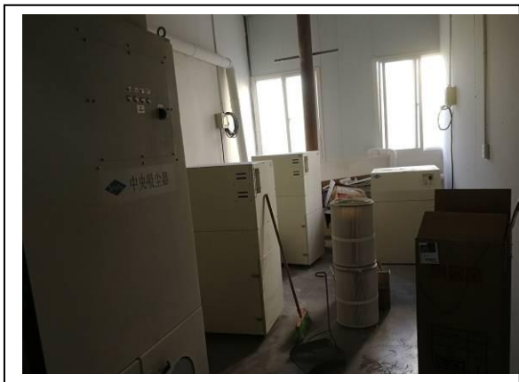
项目固定部中央除尘器
