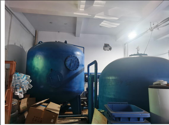
除铁除锰罐（一级过滤）
