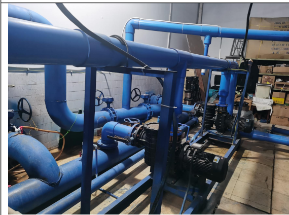
加压泵及输水管线
