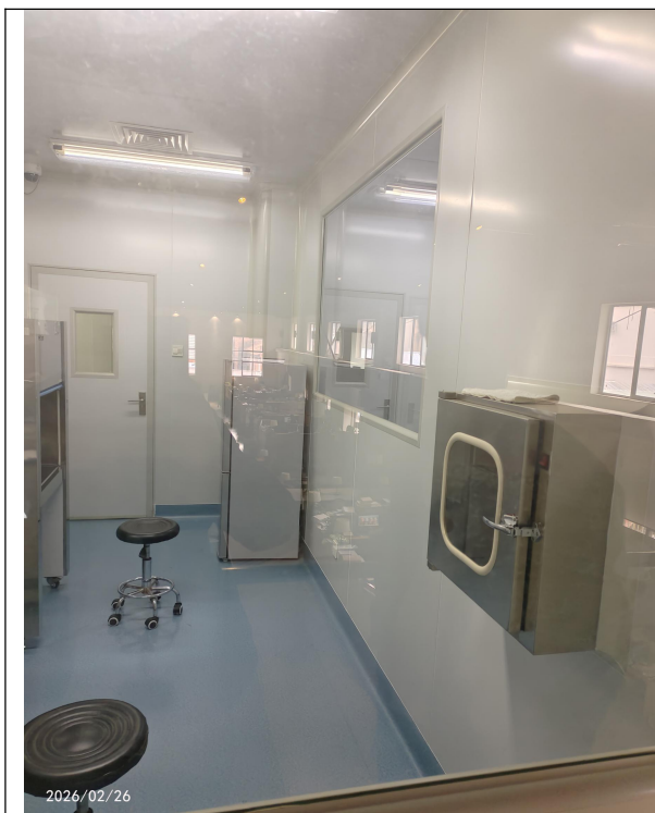
实验区抽排风设施
