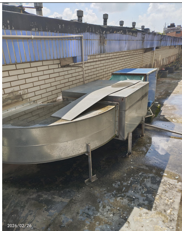
低噪音风柜及排气口
